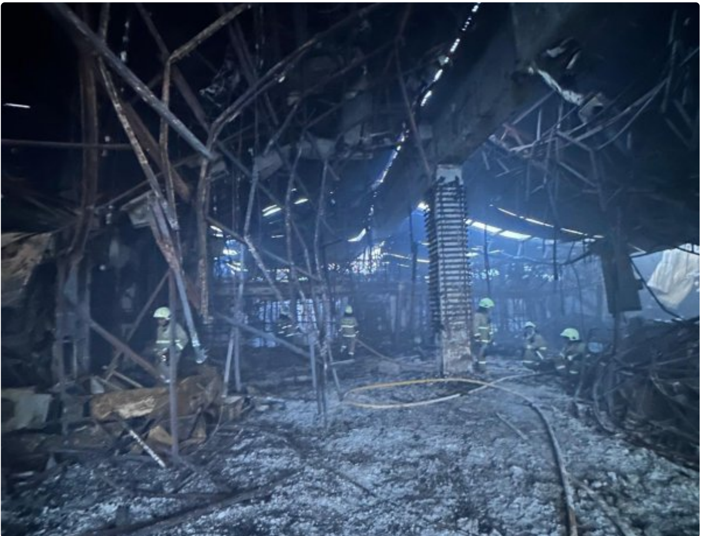
Glodok Plaza yang Hangus Terbakar
